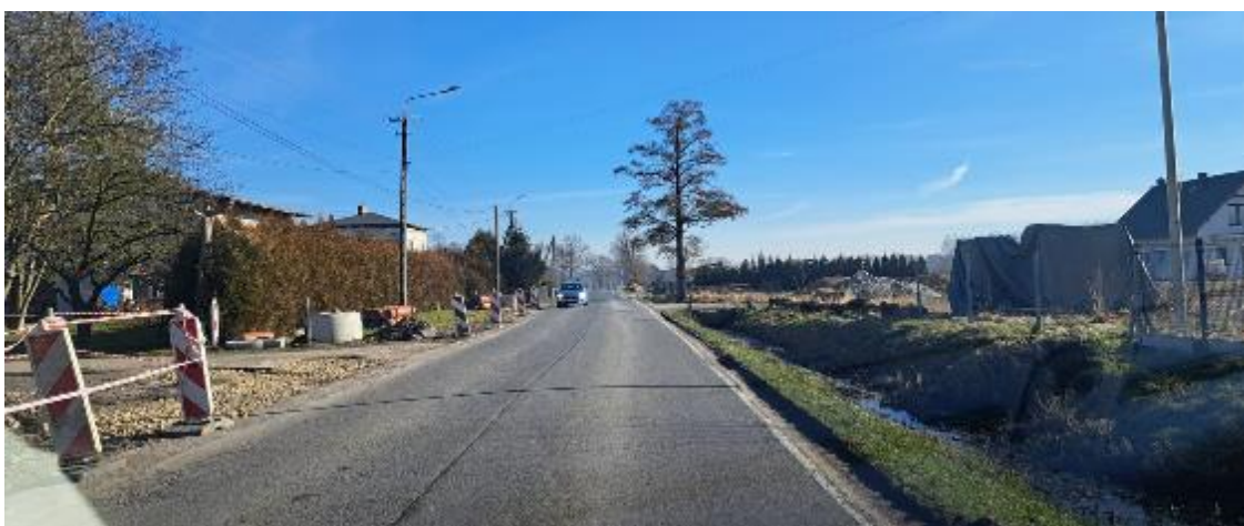
Rysunek 26 - Zdjęcie w ciągu drogi powiatowej 4428S w Ligocie (w trakcie realizacji)
